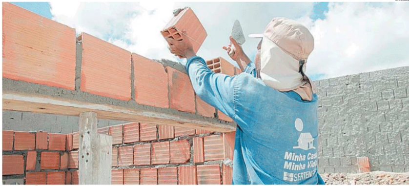
CONSTRUÇÃO de empreendimento: imóveis a partir de 80 metros quadrados devem estar inseridos dentro da nova proposta habitacional do governo
