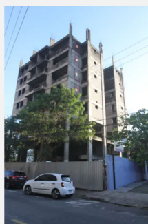
Obra do prédio não prosseguiu porque não houve interesse no investimento. Foto: Antônio Mourão/UFES
