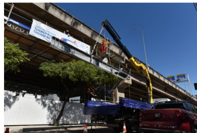
Início da montagem das estruturas metálicas das obras da Terceira Ponte. Crédito: Rodrigo Cavari
