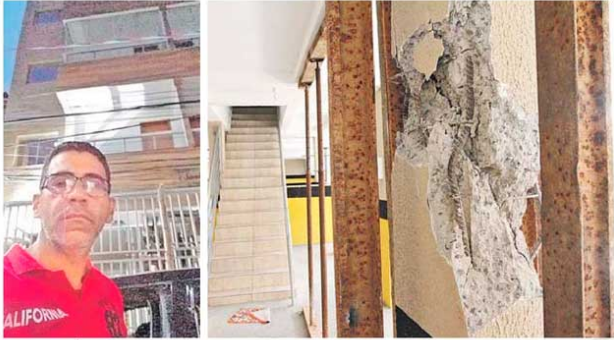
MAURO BASÍLIO contou que estava em casa, no prédio que fica em Vila Velha, quando viu duas colunas cederem
